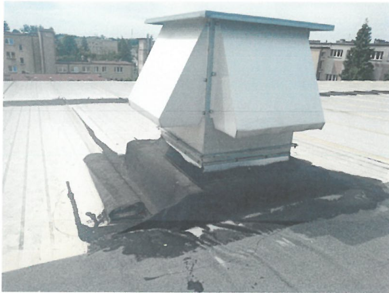
Fot. 4. Liczne naprawy nieszczelnego pokrycia dachowego, w obrębie wyrzutni dachowych
