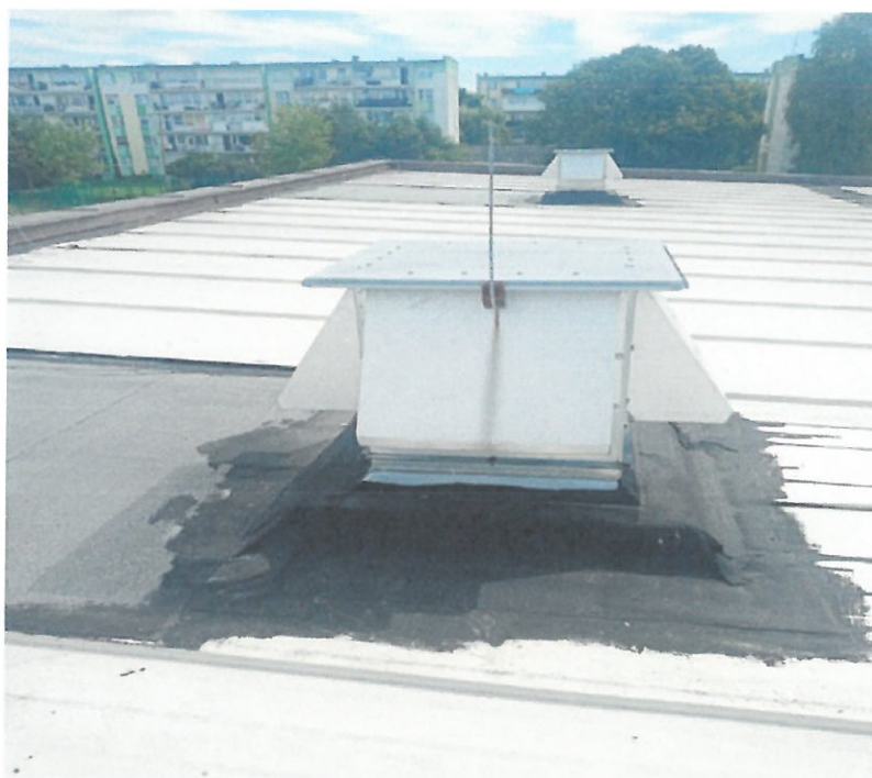
Fot. 3. Liczne naprawy nieuszczelnego pokrycia dachowego, w obrębie wyrzutni dachowych
